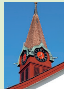
Nach einer umfassenden Revision erstrahlt das markante Türmchen auf dem unteren Ottiker Schulhaus wieder in altem Glanz.
