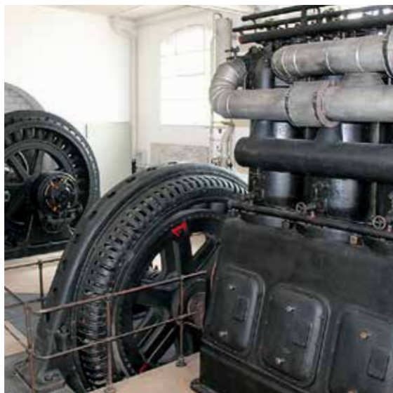
Der ursprüngliche Dieselgenerator und die alte Turbine stehen unter Denkmalschutz.
